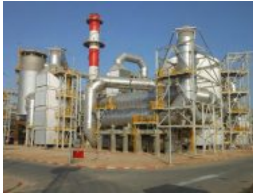
3,600 tpd SA plant – TIFERT – La Skira, Tunisia
